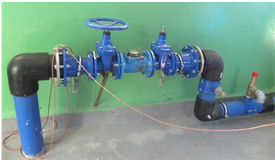
Zdjęcie nowego zaworu głównego
